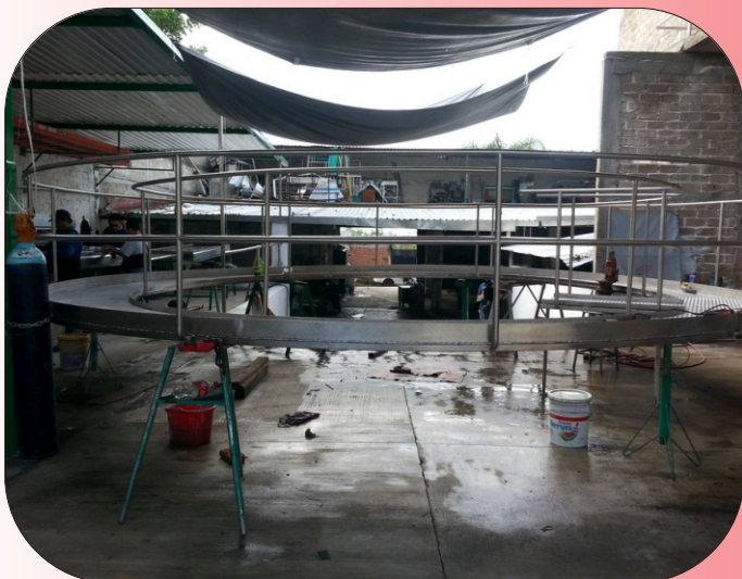
Plataforma para un enfriador
