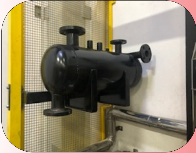
Tanque de condensados
